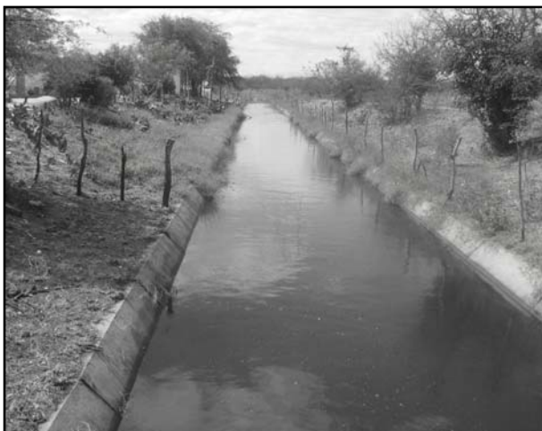
Fig. 3 - Canal principal da margem direita Fonte: Ibimirim, 2007. Créditos: Marcelo Sampaio
