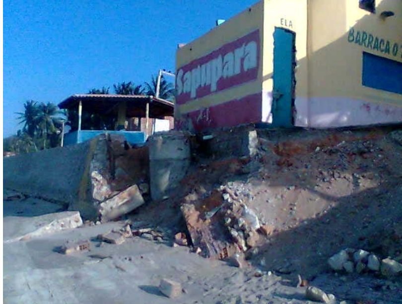
Figura 2 – Construção derrubada pelo avanço da linha de preamar.
