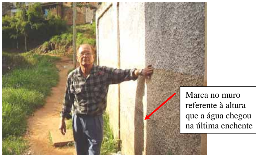
Figura 5 – Marca no muro referente à enchente ocorrida no final de 2007
