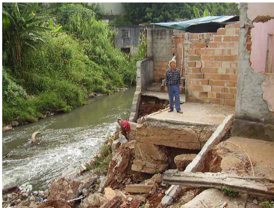
Figura 1 – Casa que desmoronou após enchente no final do ano de 2007.
