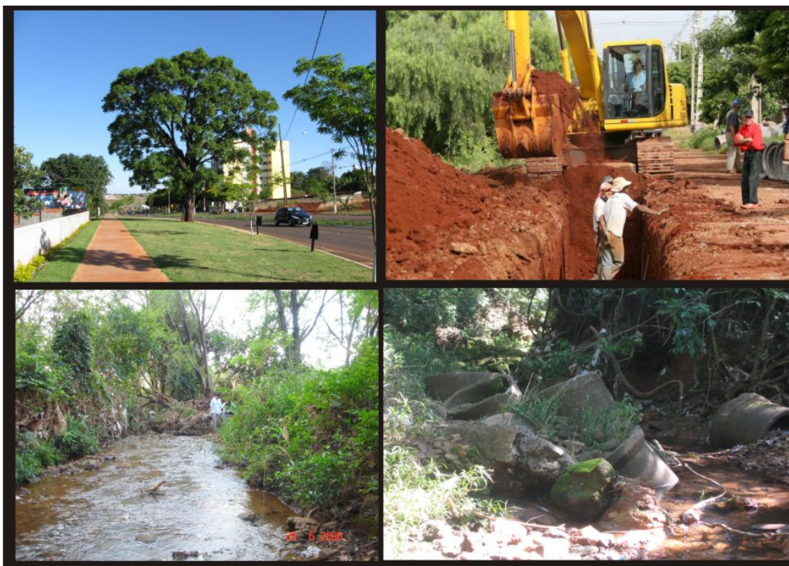
Figura 4 – As fotos da parte de cima representam ações/obras realizadas par a o bom escoamento superficial das águas pluviais, e as fotos abaixo, representam os danos causados pela força da água.
