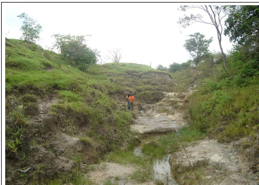
FIGURA 7: Exemplo de feição erosiva desenvolvida a partir de um canal de drenagem em um processo de expansão de suas cabeceiras.
