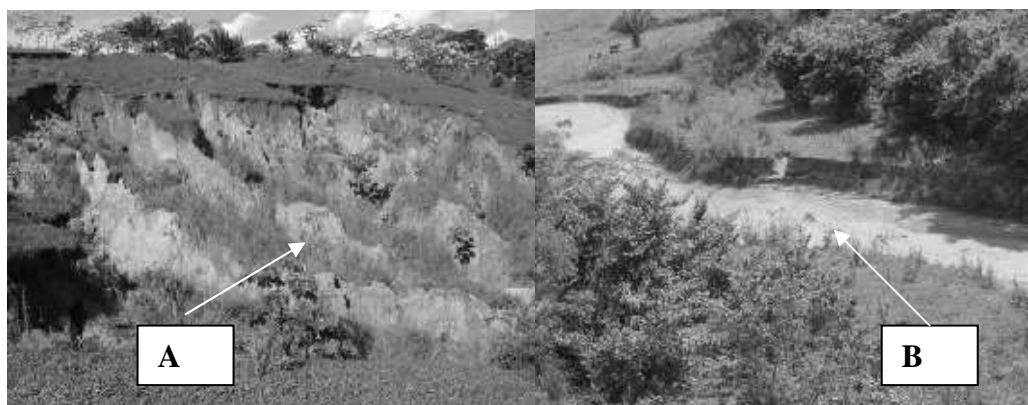
Figura 3– Erosão de encosta em áreas de cabeceira de drenagem (a) do córrego Dracena e assoreamento do canal (b) com destaque nos sedimentos arenosos.
