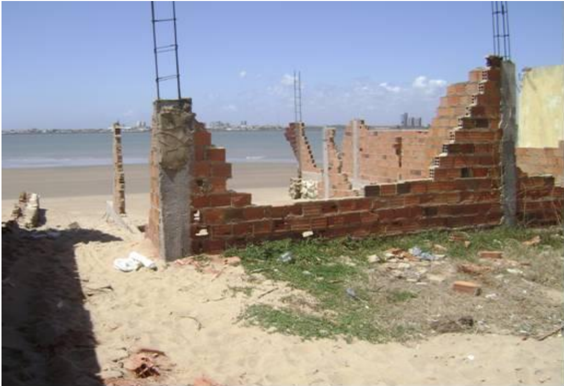
Figura 06: Ruínas na praia de Atalaia Nova – Município de Barra dos Coqueiros/Sergipe. Fonte: Trabalho de campo – 09/01/2008.
