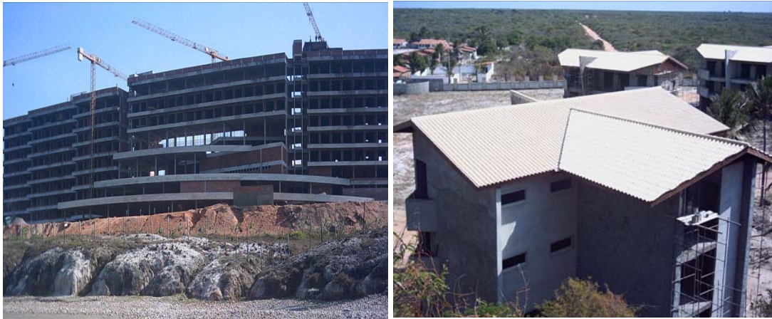
Figura 4 – Instalação de complexo turístico na Praia da Lagoinha. Fonte: Vasconcelos, F.; Martins, M. B. 2008
