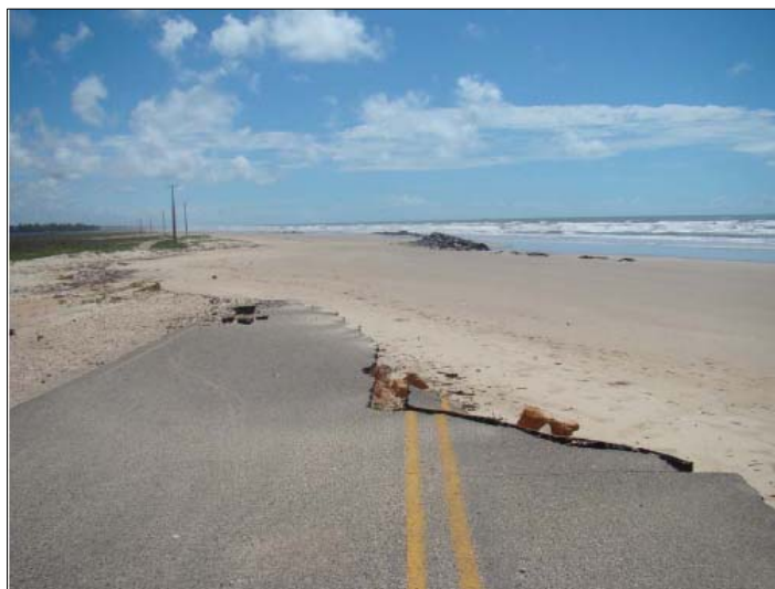
Figura 5 - Processo erosivo que resultou na destruição da rodovia José Sarney, na região da foz do rio Vaza Barris - SE.
