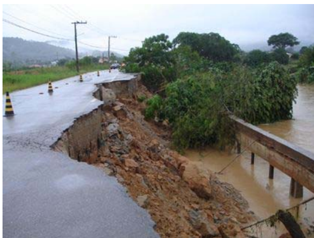
Figura 02 – Eros o fluvial, provocada pela cheia do rio Bigua u, na Avenida Jo o Frederico Martendal. (Foto: Roni Ramos, 31 de janeiro de 2008).
