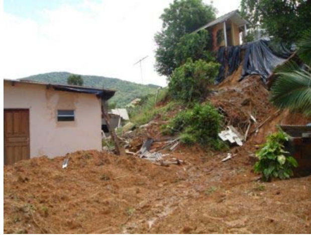
Figura 04: Deslizamento em um corte com degraus mal dimensionados, que danificou a estrutura da casa e ocasionou o entulhamento da residência a abaixo (Foto: Roni Ramos, 01 de fevereiro de 2008).
