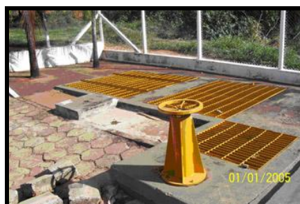
Fonte: Trabalho de campo 15/11/2006. Fotos 3: Estação Elevatória de Esgoto
