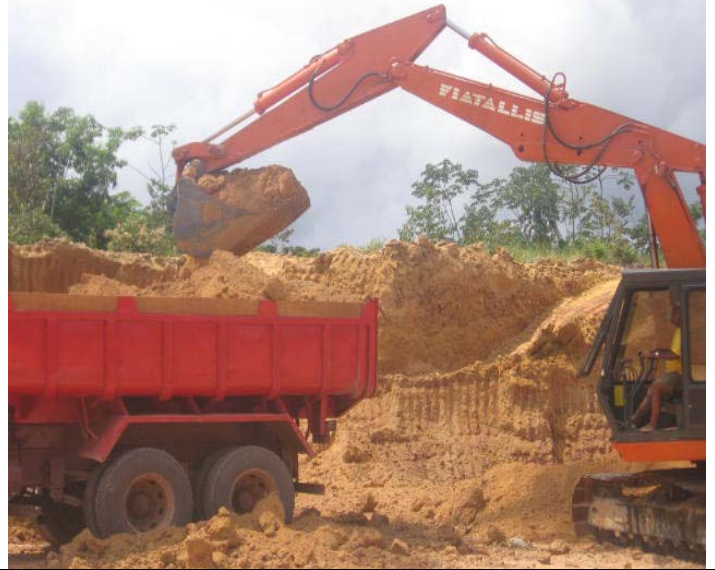
Retirada de laterita hidromórfica (piçarra) com auxílio da escavadeira, chegando a área de retirada dessa cava a medir 3 m de profundidade. FOTOS: Viviane Santos, setembro, 2007.
