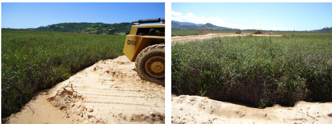
Figura 13 e 14: Crime ambiental. Aterro (terraplenagem) sobre vegetação de banhado em estágio primário (climáx-edáfico). O órgão ambiental aceitou os estudos que concluíram que a área não se enquadra como Área de Preservação Permanente (APP), não é inundável e não tem relevância para a conservação da biodiversidade.
