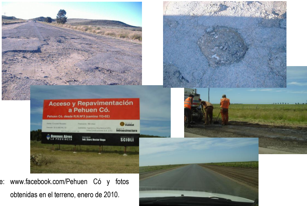
Figura 4. Estado de deterioro y estado actual del camino de acceso
